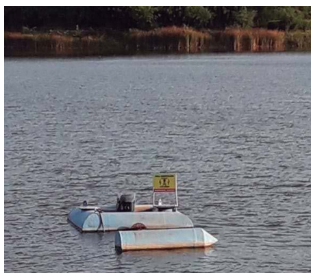
Foto 12 – Captação – açude DNOCS.
