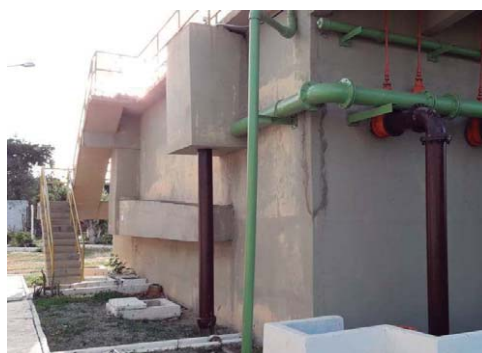
Foto 15 – Floco-decantdor - ETA de Tremedal
