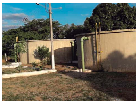
Foto 14 – Reservatórios de distribuição (RAD) - ETA de Tremedal.
