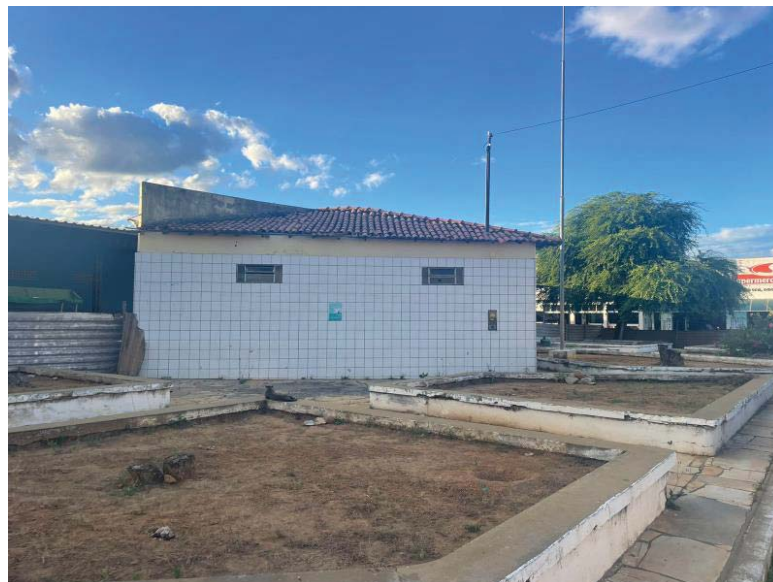
Figura 6 - Irá demolir o banheiro e demais canterios, para execução correta do projeto.
