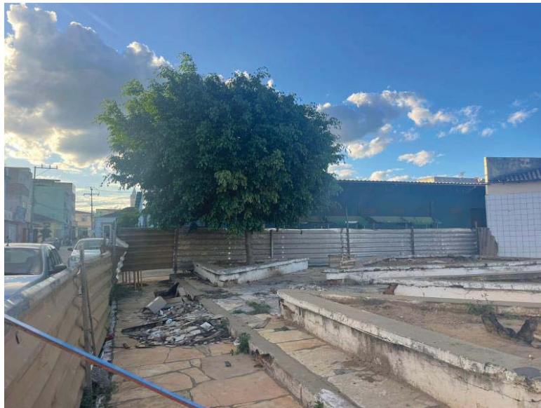
Figura 4 - Árvore será demolida e irá implantar uma adequada no local.
