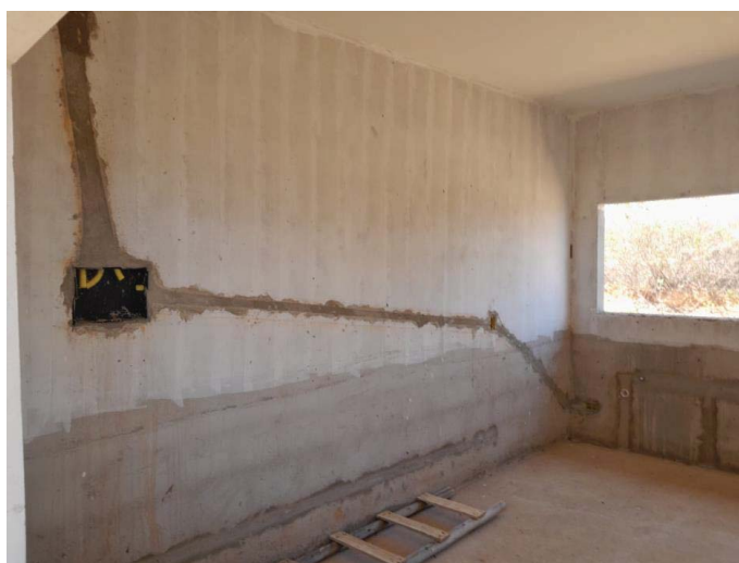
Figura 31 - Instalação de Quadro de distribuição, em ponto correto, no entanto apenas a caixinha do fundo. Fonte: elaboração própria.
