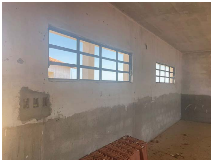
Figura 27 - Ausência de revestimento na sala, vidro na janela. Fonte: elaboração própria.
