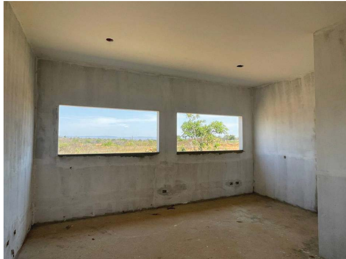
Figura 18 - Ausência de esquadrias, lâmpadas, cabeamento e tomadas.
