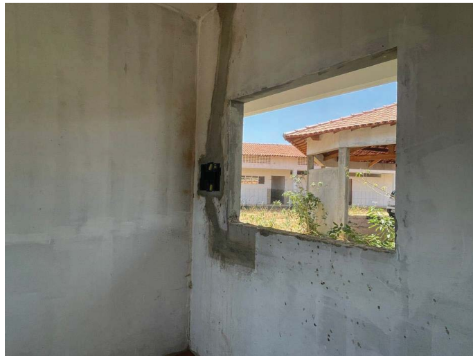
Figura 17 - Apenas o fundo da caixa de distribuição. Fonte: elaboração própria.
