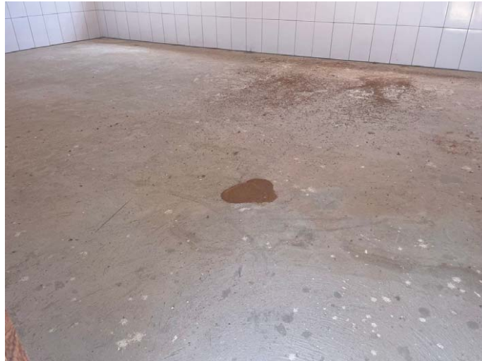
Figura 23 - Presença de formigueiro em alguns pontos. Fonte: elaboração própria.
