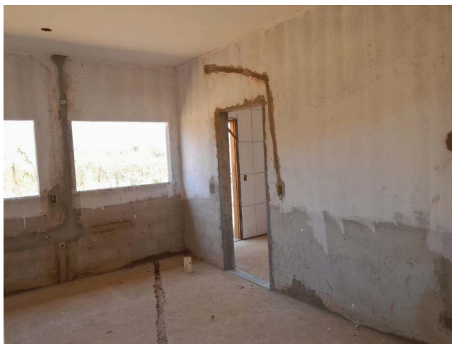
Figura 30 - Ausência de revestimento nas paredes e bancada em granito. Fonte: elaboração própria.
