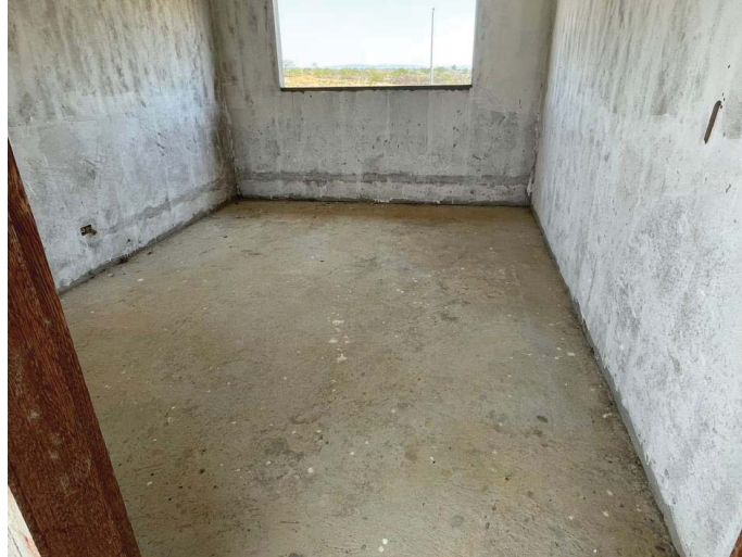
Figura 16 - Contrapiso executado, ausência de piso. Fonte: elaboração própria.
