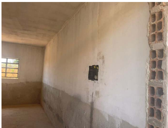
Figura 28 - Presença do fundo do Quadro de distribuição. Fonte: elaboração própria.
