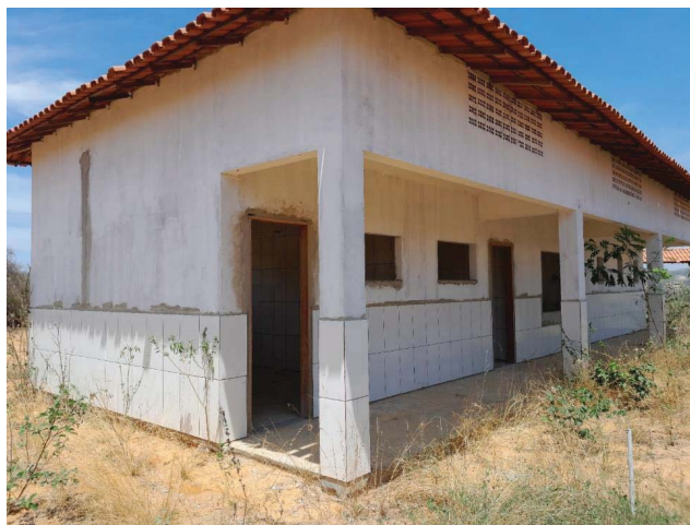
Figura 29 - Pintura seladora apenas uma demão, ausência de revestimento para piso. Fonte: elaboração própria.
