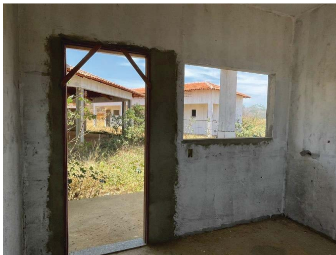
Figura 14 - Não foram instaladas as portas, apenas os batentes para o recebimento, foram instaladas as caixinhas 4x2. Fonte: elaboração própria.
