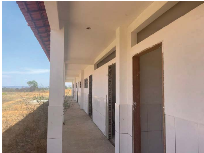
Figura 24 - Ausência de soleiras, portas e janelas em duas salas. Fonte: elaboração própria.
