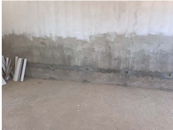
Figura 25 - Ausência de revestimento e bancada na sala de computação. Fonte: elaboração própria.
