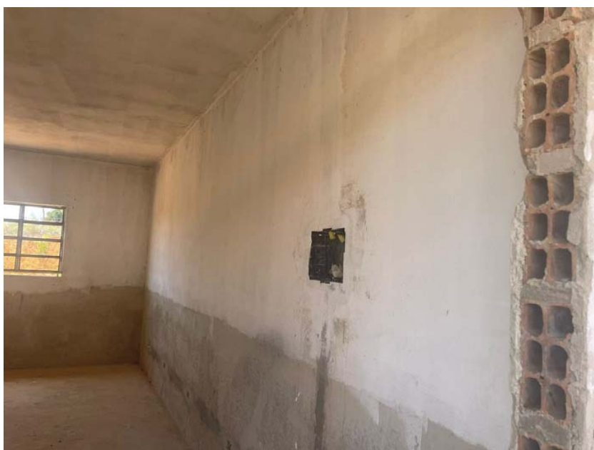
Figura 28 - Presença do fundo do Quadro de distribuição. Fonte: elaboração própria.
