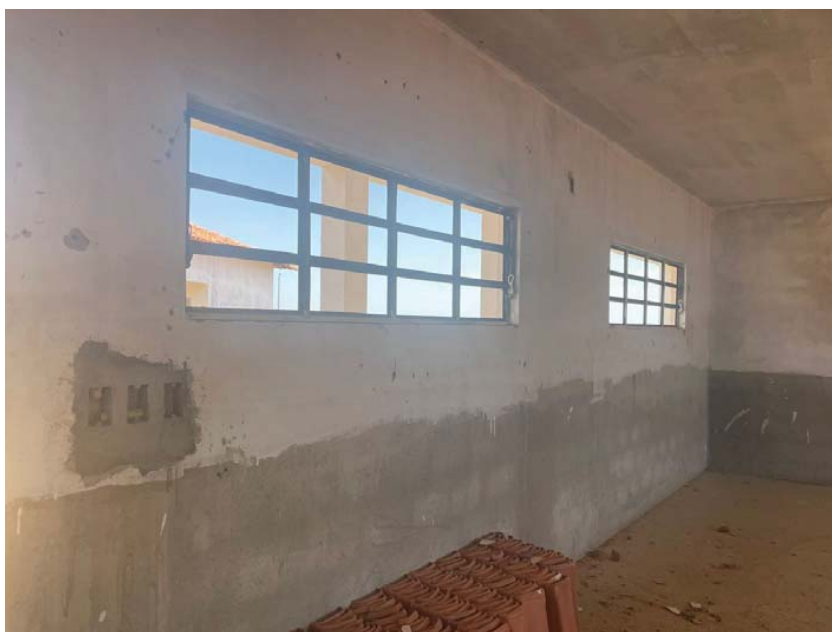
Figura 27 - Ausência de revestimento na sala, vidro na janela. Fonte: elaboração própria.
