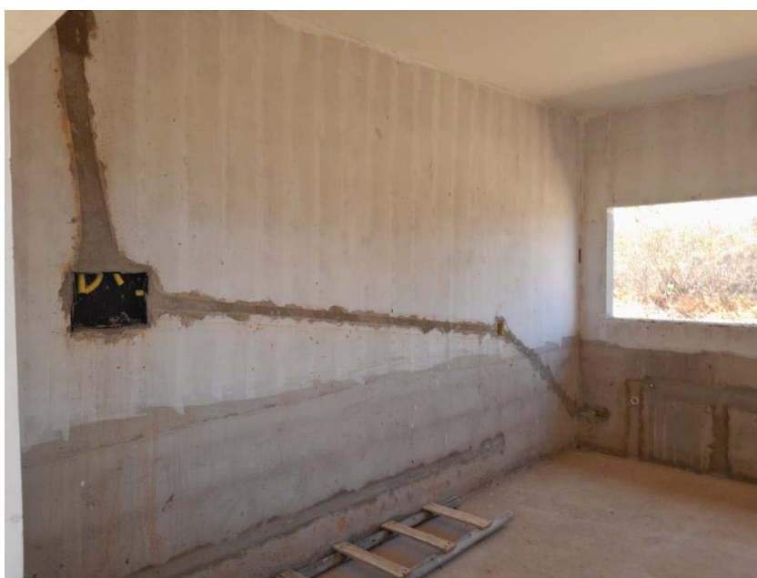
Figura 31 - Instalação de Quadro de distribuição, em ponto correto, no entanto apenas a caixinha do fundo. Fonte: elaboração própria.
