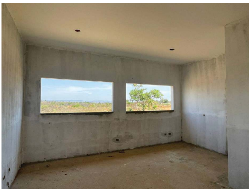
Figura 18 - Ausência de esquadrias, lâmpadas, cabeamento e tomadas.
