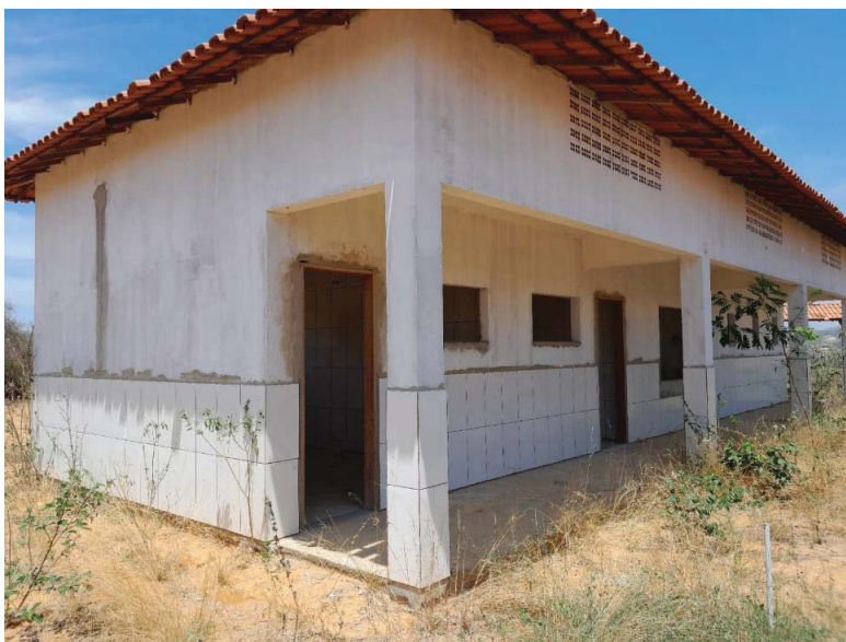
Figura 29 - Pintura seladora apenas uma demão, ausência de revestimento para piso. Fonte: elaboração própria.
