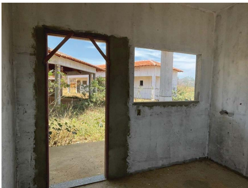
Figura 14 - Não foram instaladas as portas, apenas os batentes para o recebimento, foram instaladas as caixinhas 4x2. Fonte: elaboração própria.
