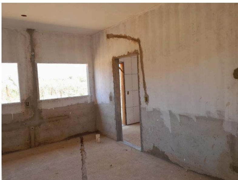
Figura 30 - Ausência de revestimento nas paredes e bancada em granito. Fonte: elaboração própria.
