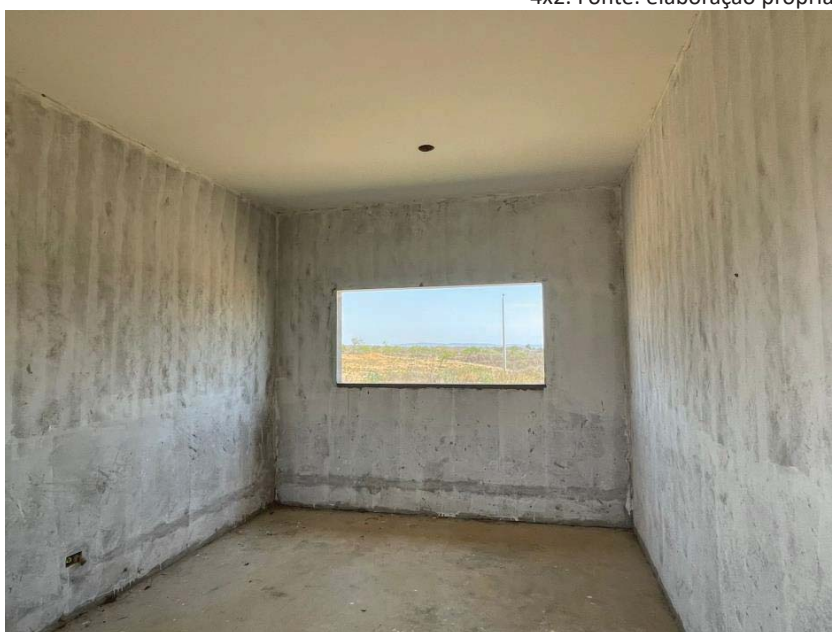
Figura 15 - Presença de pintura seladora e Caixinha para recebimento de tomada e lâmpadas, já com eletrodutos passados. Fonte: elaboração própria.
