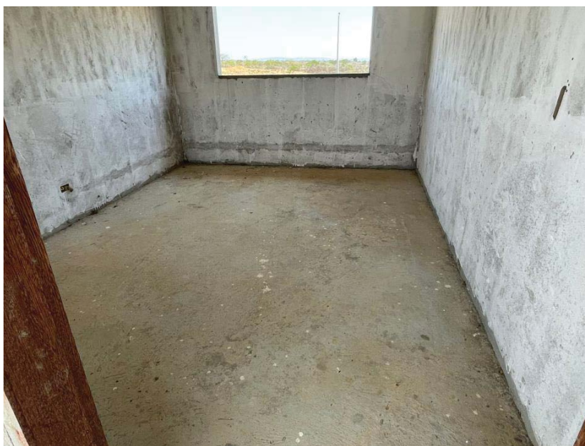
Figura 16 - Contrapiso executado, ausência de piso. Fonte: elaboração própria.
