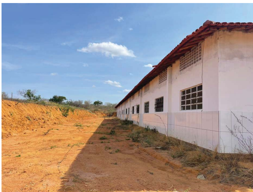
Figura 8 - Vista dos Fundos do terreno e do bloco pedagógico. Fonte: elaboração própria.
