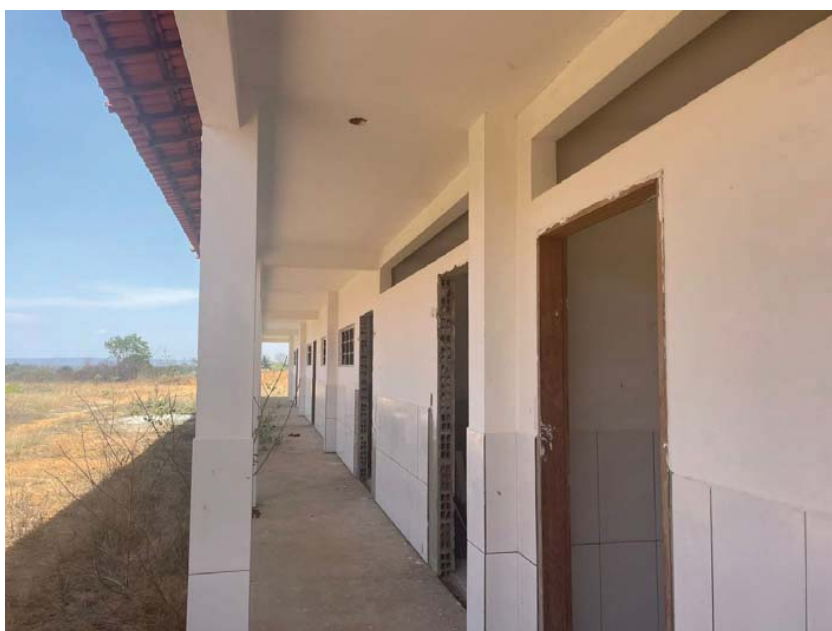
Figura 24 - Ausência de soleiras, portas e janelas em duas salas. Fonte: elaboração própria.
