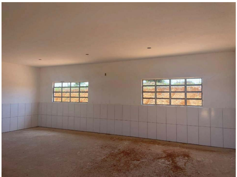
Figura 22 - Ausência de vidros na estrutura de janela. Fonte: elaboração própria.
