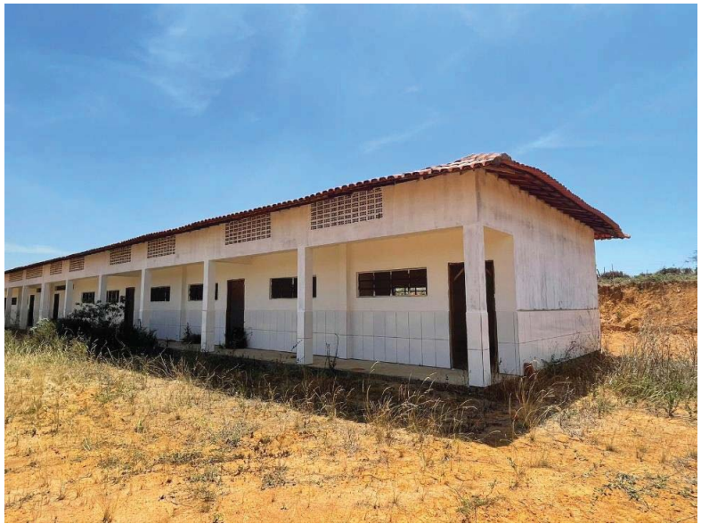
Figura 21 - Estrutura do telhado em risco, bastante danificada do bloco pedagógico.
