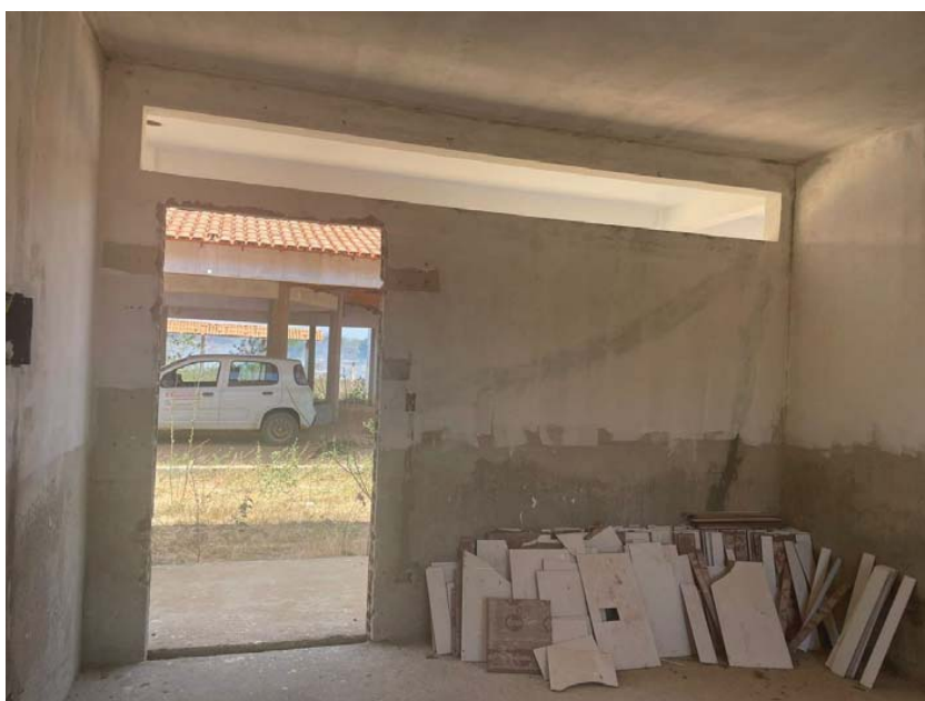
Figura 26 - Ausência de porta, soleira e janela. Fonte: elaboração própria.
